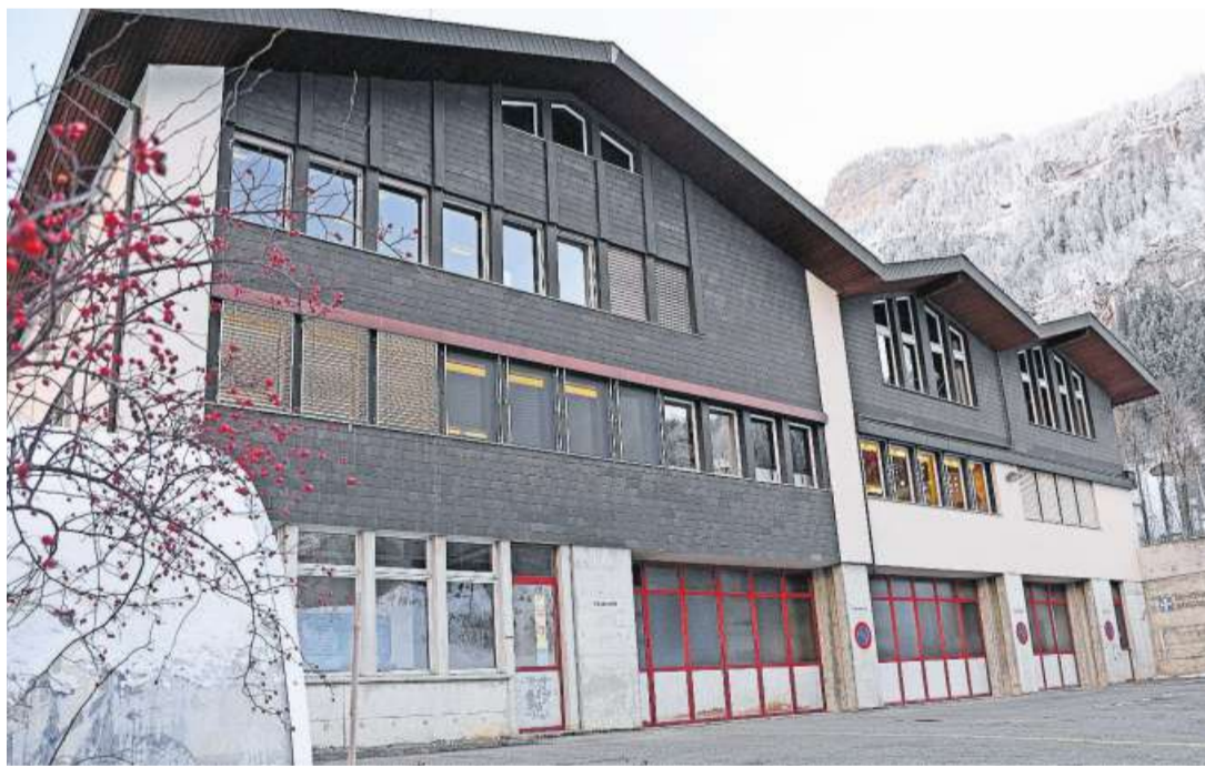
Das Mehrzweckgebäude Lungern ist in einem schlechten Zustand. Bild: Robert Hess (Lungern, 7. Januar 2021)
